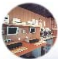
LANs marítimas de cobre/ fibra para monitoramento remoto, controle, manutenção, transferência de dados e entretenimento
